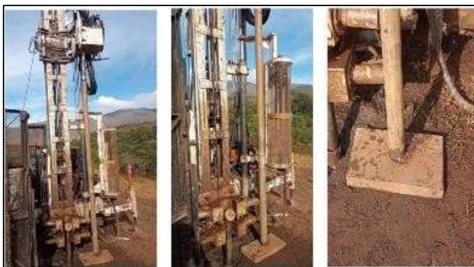
Exemplo de bloqueio de energia gravitacional com uso de haste em atividade de ensaios
